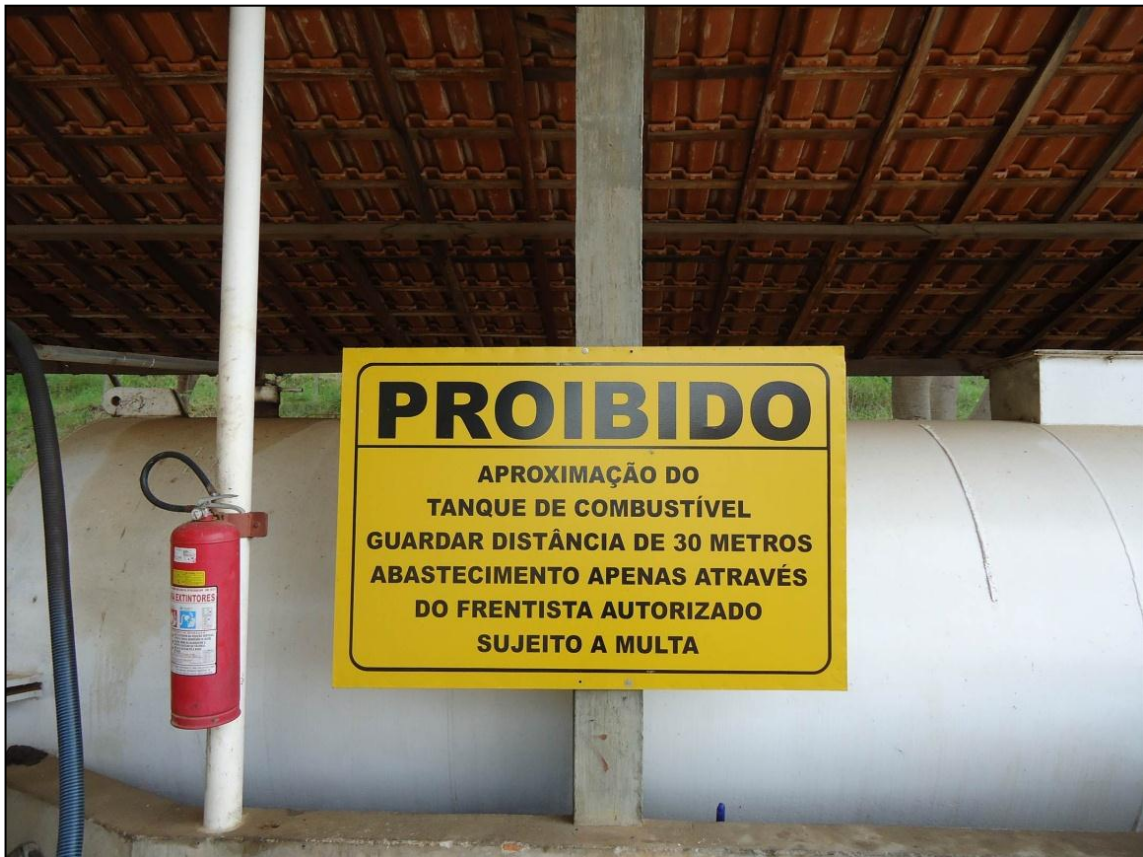
Foto 18 - Tanque de combustível isolado e disposto de placa de proibição de aproximação e extintor de incêndio.
