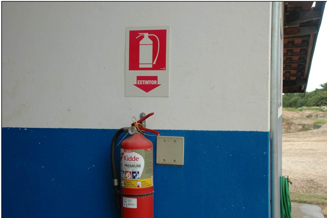
Foto 22 - Extintor de incêndio.
